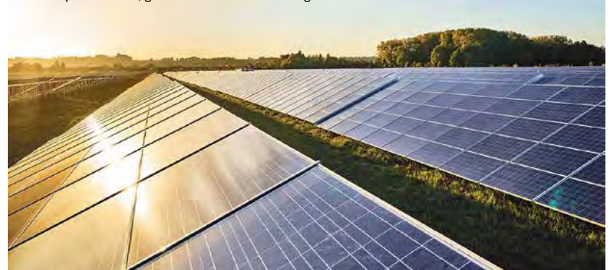
Solarpark Nordendorf, Deutschland Von hep entwickelt, gebaut und seit 2009 im eigenen Betrieb
